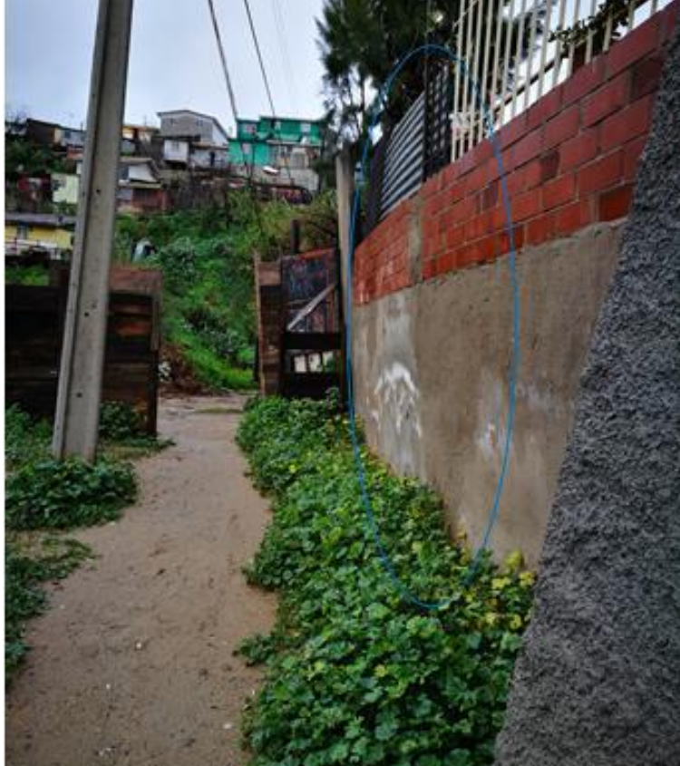
Ilustración 88 Muro de contención con evidente deformación horizontal.
