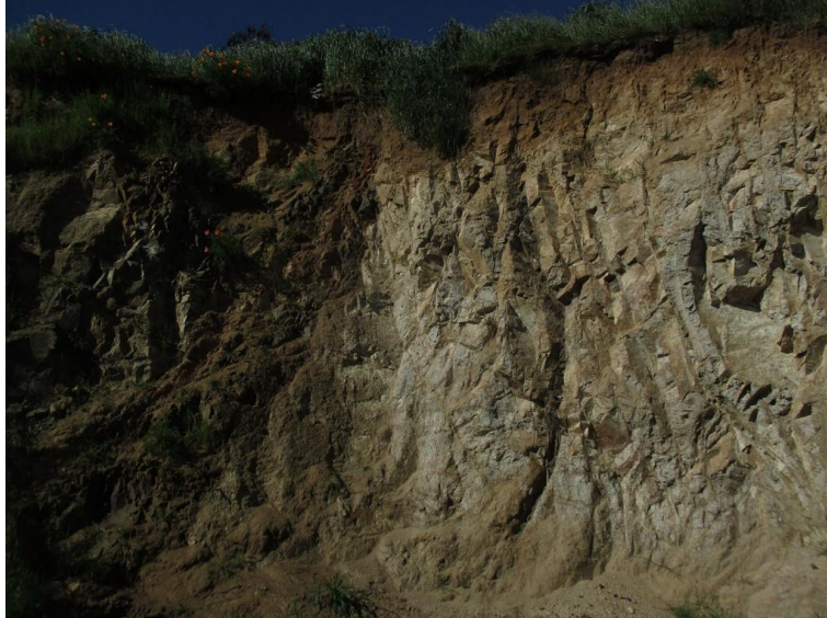
Ilustración 76 Taludes de corte erosionados por el agua de escorrentía.
