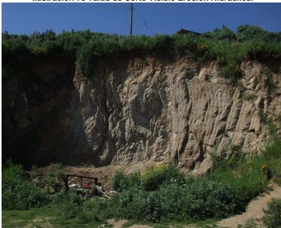
Ilustración 73 Talud de Corte Visible Erosión Hidráulica.
