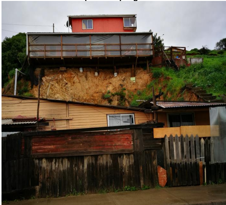
Ilustración 89 Terraza expuesta a peligro inminente de derrumbe.
