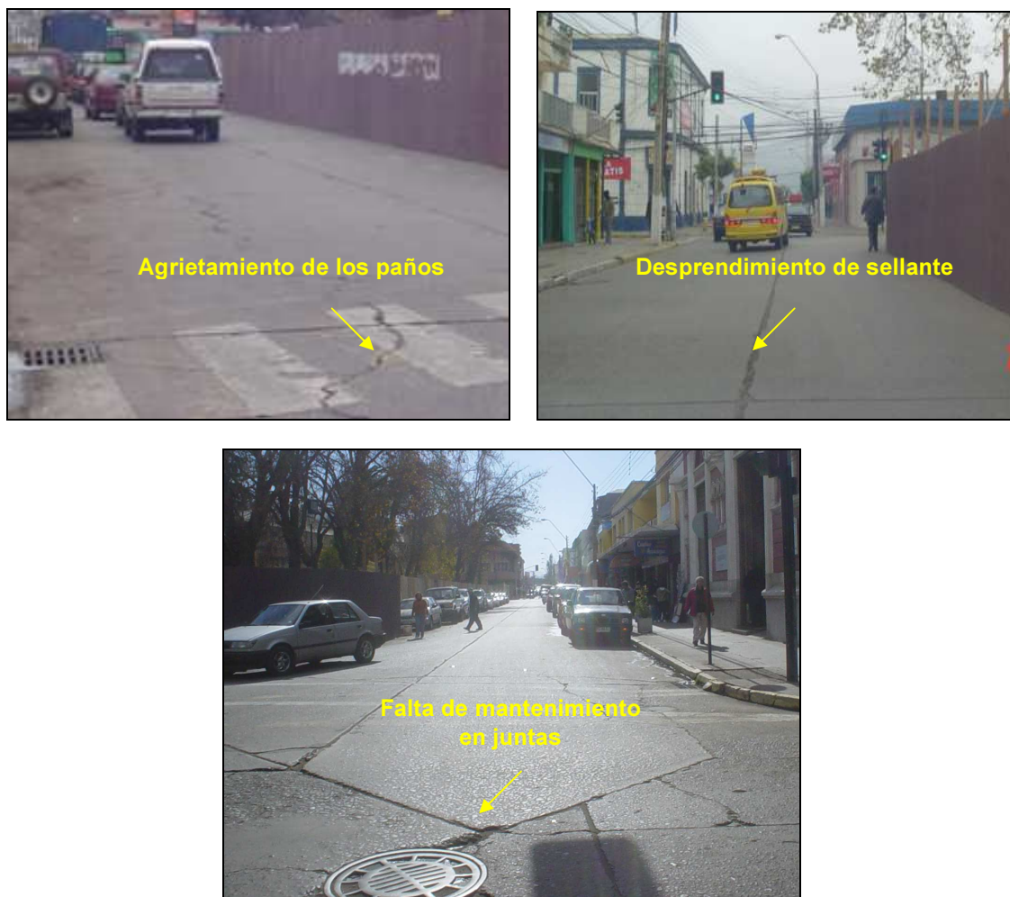
Figura 9. Vista general del estado de conservación de los pavimentos
